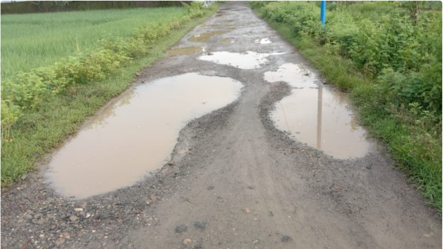
Belum Ada Perhatian, Jalan Perumahan Griya Citramas Menuju Kantor Daerah Pangkep Biraeng Rusak Parah
